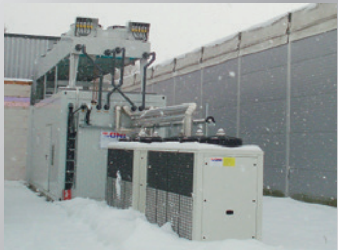
Modulare Energiezentrale für die Kühl- und Kaltwasserversorgung eines kunststoffverarbeitenden Betriebs. Die Kältemaschine ist im Winterschlaf und wird durch die ONI-Winterentlastung ersetzt. Modular energy center for the cooling and cold water supply of a plastics processing company. The chiller is in its winter sleep and is replaced by an ONI winter relief.
