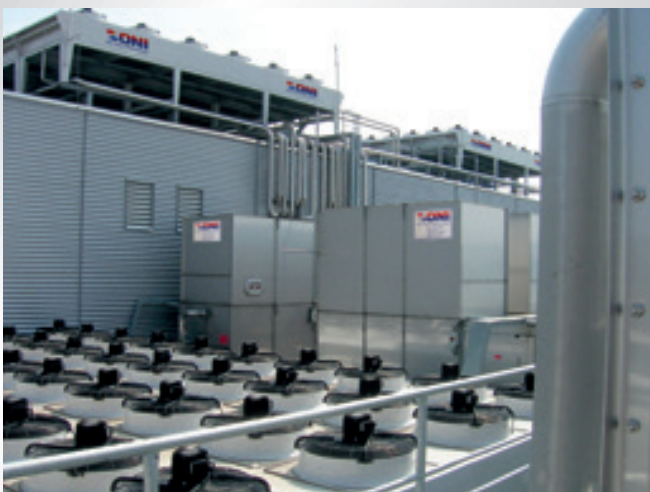
Kühlanlagentechnik eines Produktionsbetriebs Medizintechnik mit Winterentlastung und Wärmerückgewinnung Cooling system technology of a production plant for medical instruments with winter relief and heat recovery
