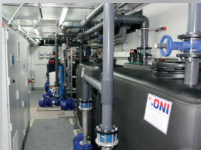
Blick in einen Teil einer modularen Kühlenergiezentrale mit Pumpen-Tankeinheit View of a part of a modular cooling energy center with a pump tank unit
