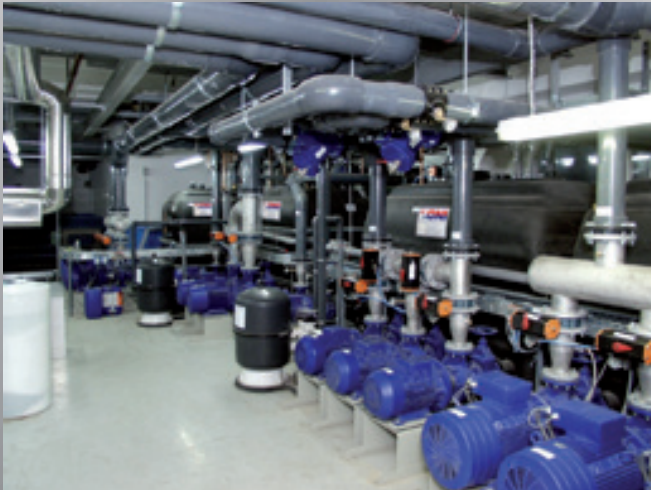
Energetisch optimierte Kühlanlage zur Versorgung von Produktionsmaschinen sowie Klima- und Lüftungsanlagen. Mit Wärmerückgewinnung zur Nutzung kostenloser Abwärme und einer glykolfreien Winterentlastung zur Stromverbrauchsreduzierung der Kältemaschinen Energy-optimized cooling system for feeding production machines as well as air-conditioning and ventilation systems. With heat recovery for using cost-free waste heat and a non-glycol winter relief for reducing the power consumption of chillers
