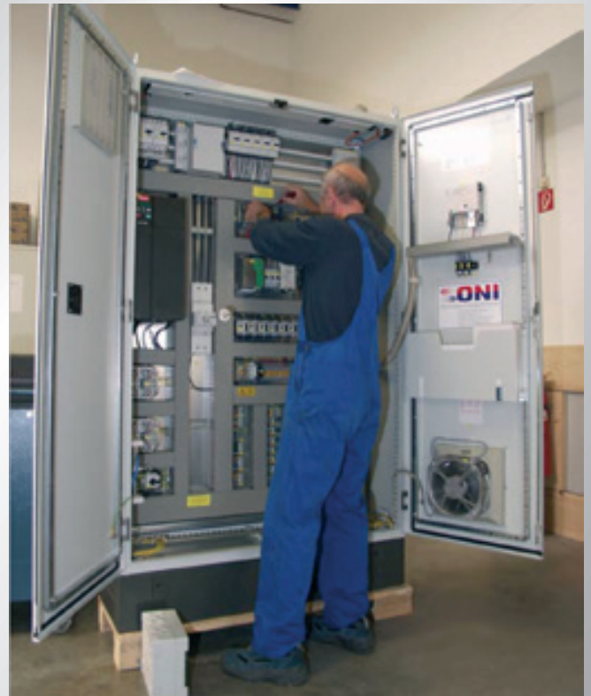
Endmontage einer mittelgroßen Schaltschrankeinheit Final assembly of a medium-sized switchgear cabinet unit
