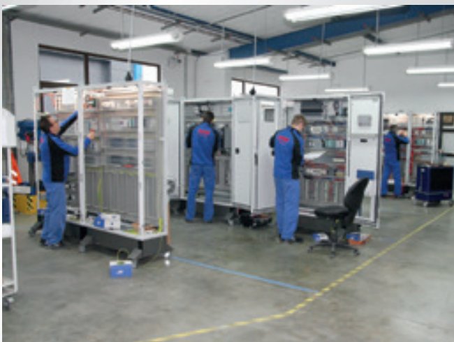
Blick in einen Teilbereich der ONI-Schalterschrankfertigung View of a partial area of ONI switchgear cabinet production
