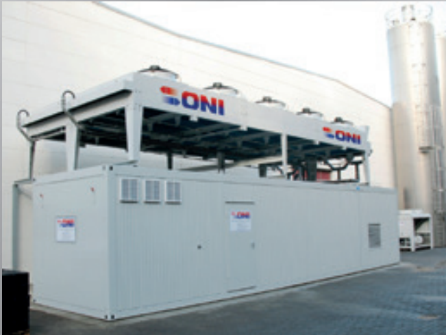
Zentralmodul einer Energiezentrale mit aufgesetzten, glykolfreien Freikühlern für ein Zweikreis-Kühlsystem mit Winterentlastung. Central module of an energy center with glycol-free outdoor coolers on the top for a double-circuit cooling system with winter relief.
