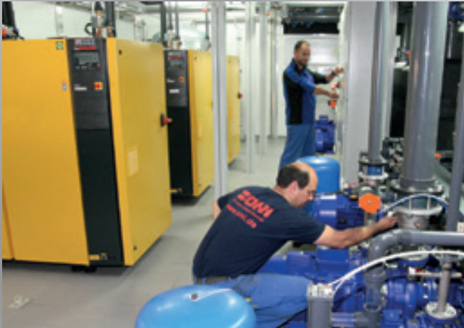
Zentrale Druckluftversorgung mit Abwärmenutzung aus den Kompressoren für die Heizwärmeversorgung Centralized compressed-air supply including use of the heat dissipation by the compressors for heating power supply
