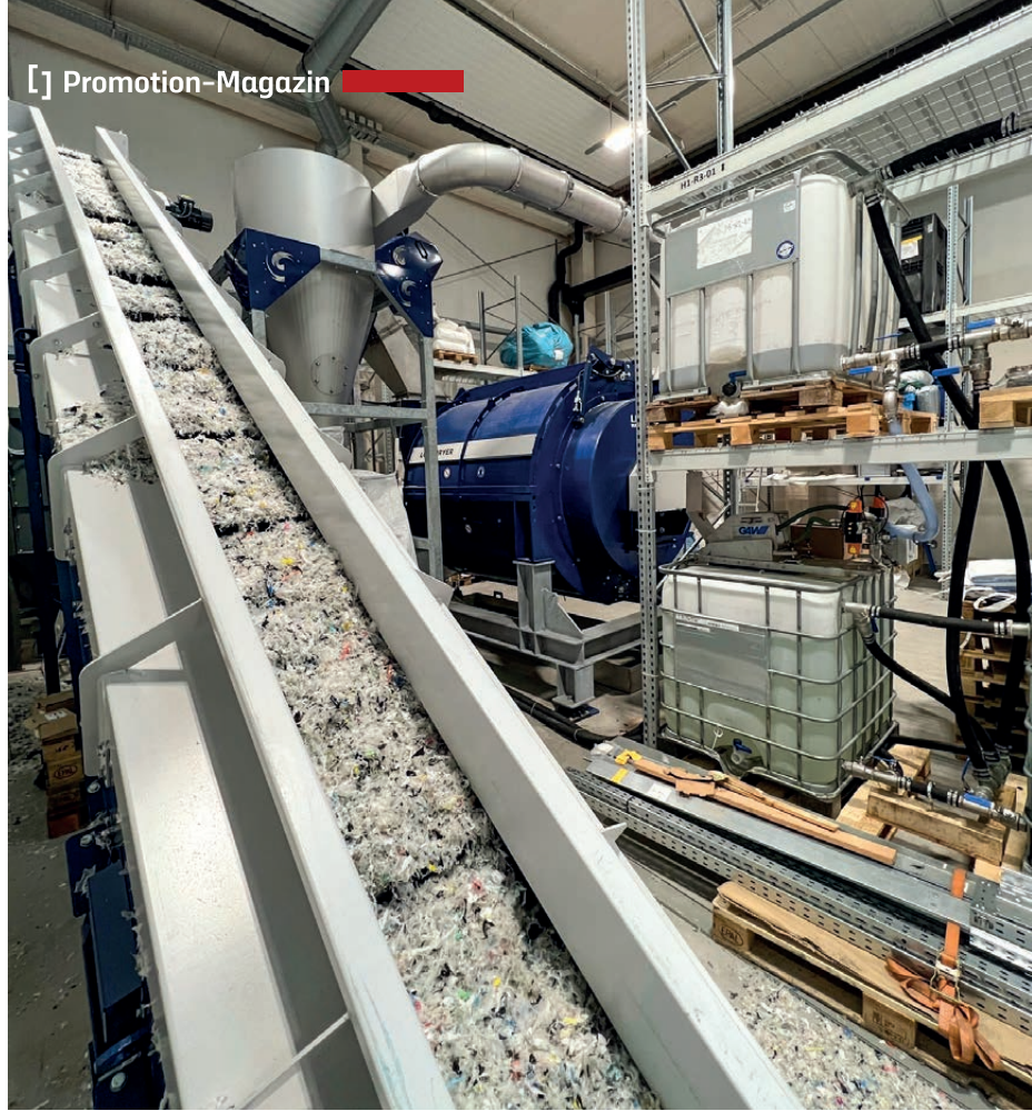
Im Rahmen des Forschungsprojekts circPLAST-mr werden an der Technikumsanlage der LIT Factory an der JKU Linz Testversuche durchgeführt.
